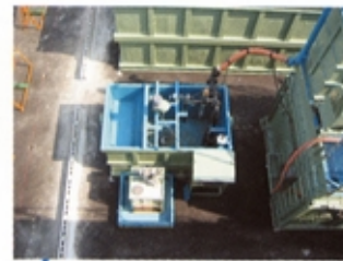
pH処理装置(希硫酸注入方式) 処理能力/10~50m³/H(4機種)
